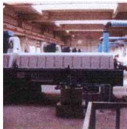
Uso de maquinaria para deshidratar lodos.
